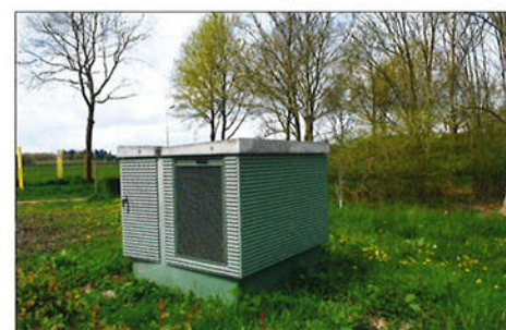
Een nieuw trafohuisje aan de Reuvekampsweg. Beter passend in de omgeving
